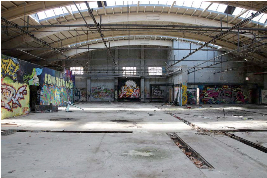
Zustand der nicht betroffenen Halle 53 nach dem Brand
